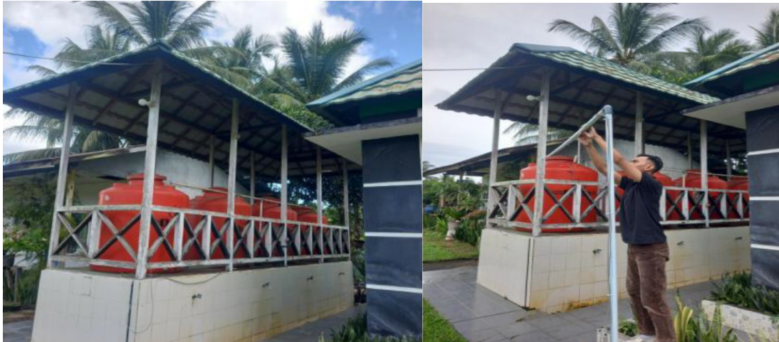
Gambar 4. 10 Sistem Kontrol Pompa Otomatis Tandon Air Wudhu
